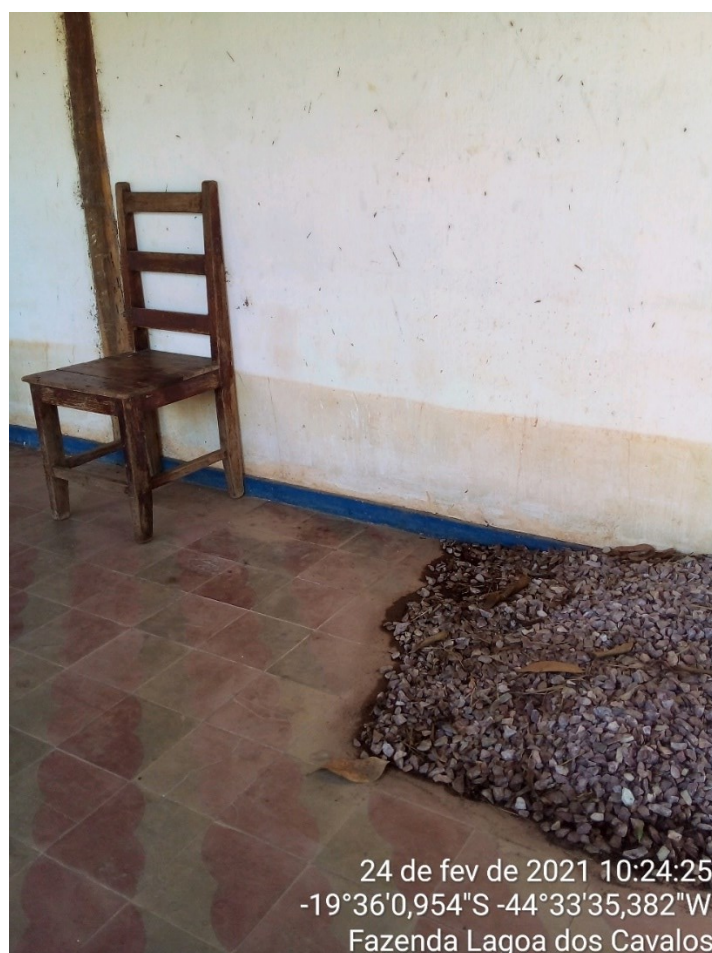
Figura 13: Altura da coluna de água em uma das edificações atingidas pelas cheias do rio Paraopeba na Comissão de Córrego da Areia, em Fortuna de Minas, Minas Gerais.
