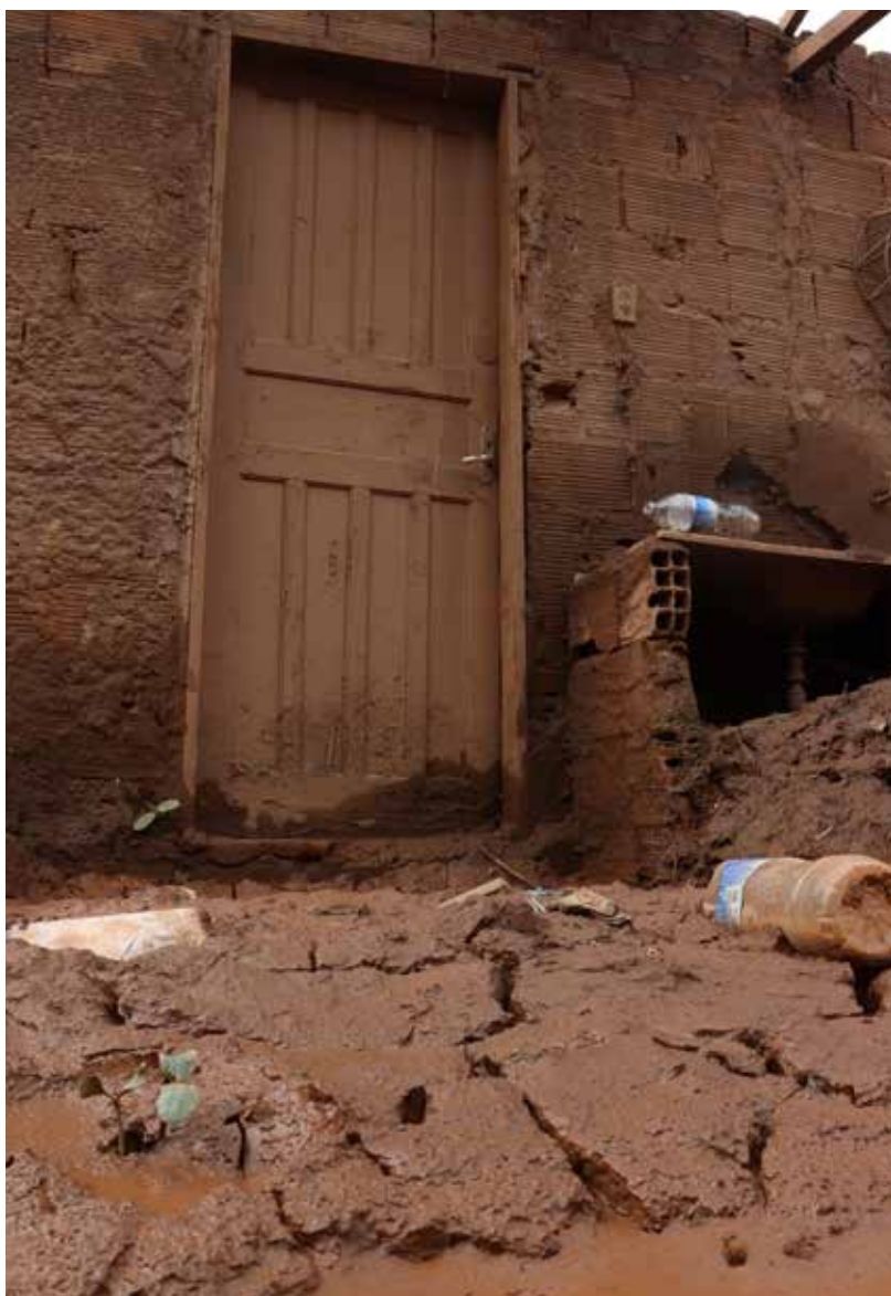
Detalhe de casa praticamente soterrada pelo rejeito, após a enchente que assolou a comunidade de Padre João, em Esmeraldas (jan/2022)
